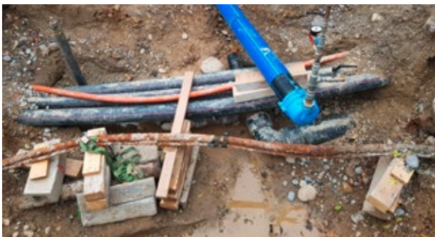
Leitung in Dorfstrasse
